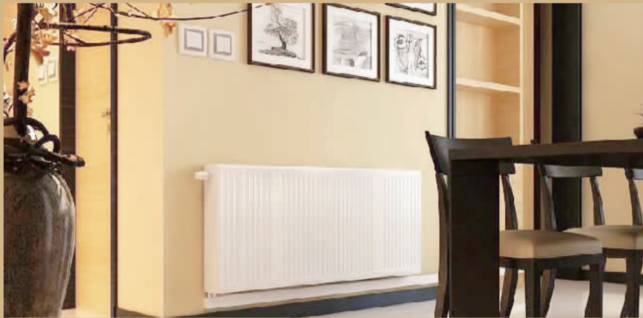
居民家中的天然气采暖设施
